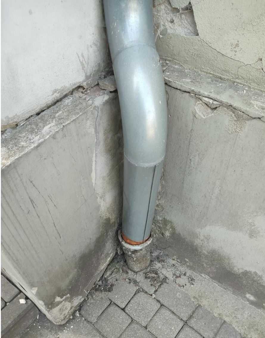
Fot.7 Uszkodzenia cokołu od strony wschodniej w obrębie rury spustowej
