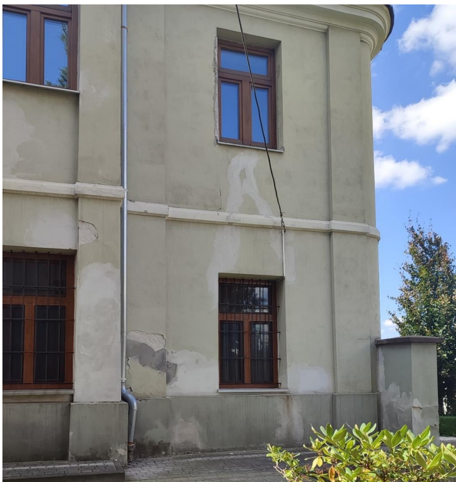
Fot.8 Uszkodzenia/pęknięcia/zarysowania elewacji wschodniej
