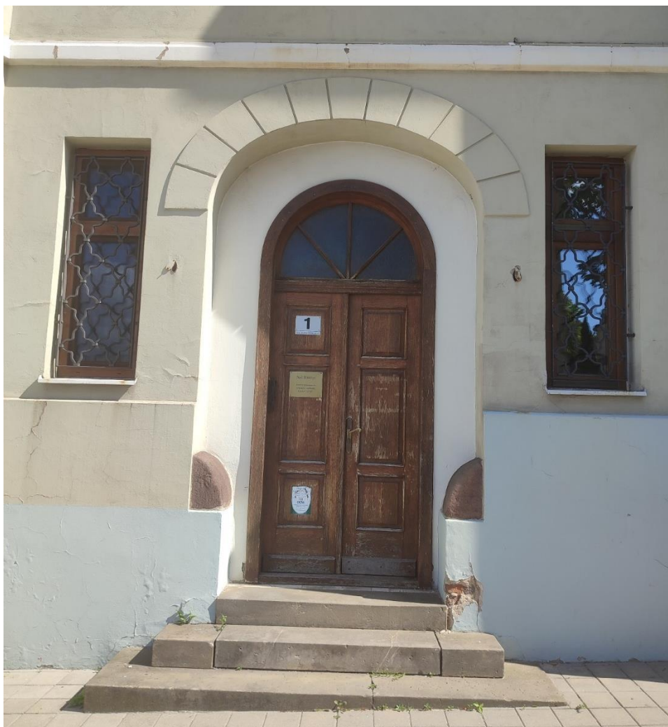
Fot.16 Boniowanie, elementy kamienne, schody elewacji zachodniej. Uszkodzenia tynku w obrębie wejścia
