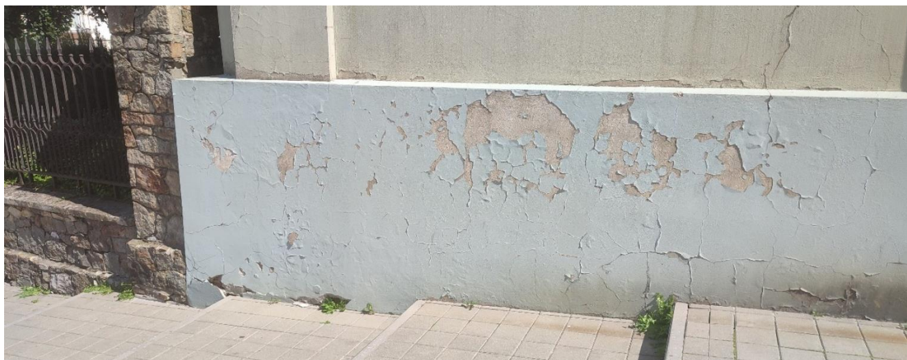
Fot.11 Spękania tynku i złuszczenia powłok malarskich strefy cokołowej od strony zachodniej
