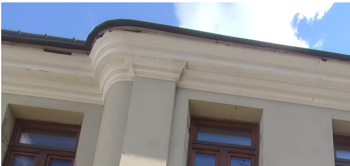
Fot.18 Przykładowe uszkodzenia gzymsów na styku z obróbką blacharską
