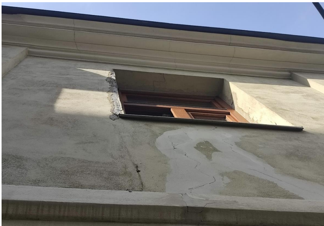
Fot.17 Przykładowe zarysowania gzymsów i ścian elewacji wschodniej
