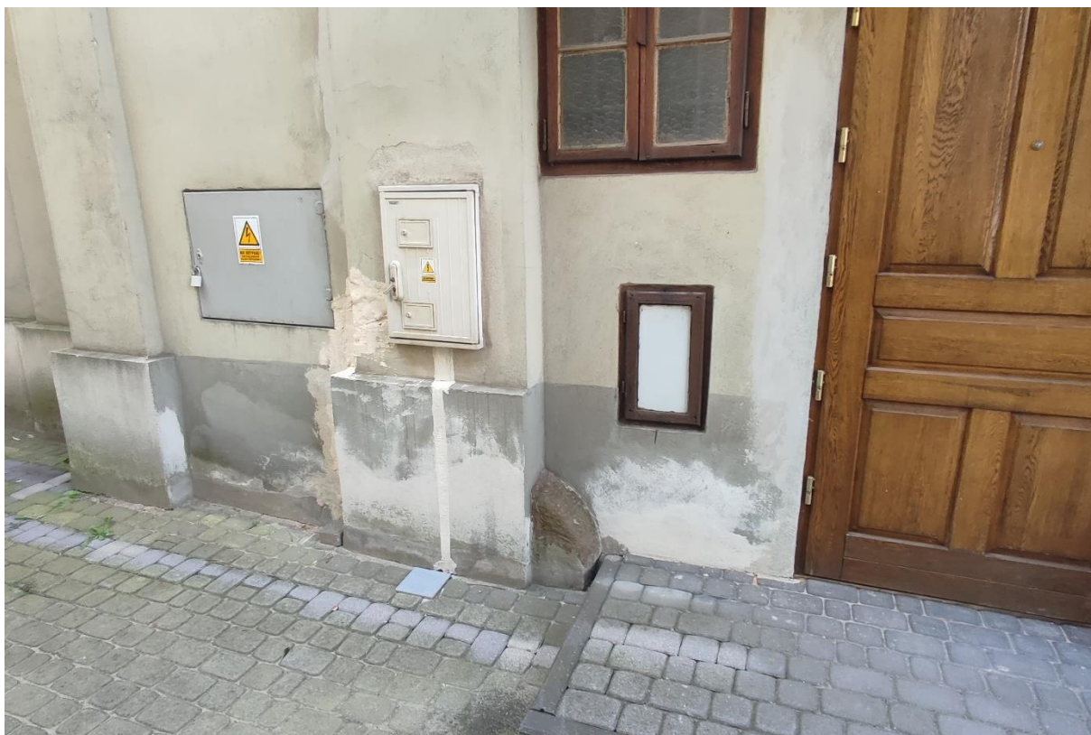
Fot.12 Widoczne niestaranne/nieestetyczne ślady montażu instalacji
