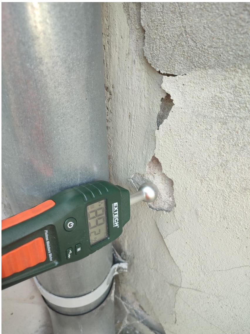
Fot.14 odspojenie powłok, osypywanie się i zawilgocenie tynku
