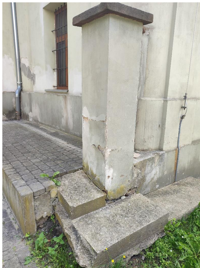
Fot.13 Uszkodzenia tynków, odspojenia opaski oraz agresja mikrobiologiczna w narożniku północno - wschodnim
