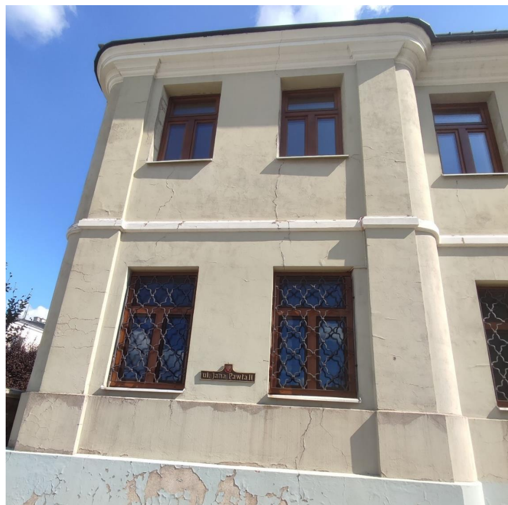
Fot.9 Uszkodzenia/pęknięcia/zarysowania elewacji zachodniej
