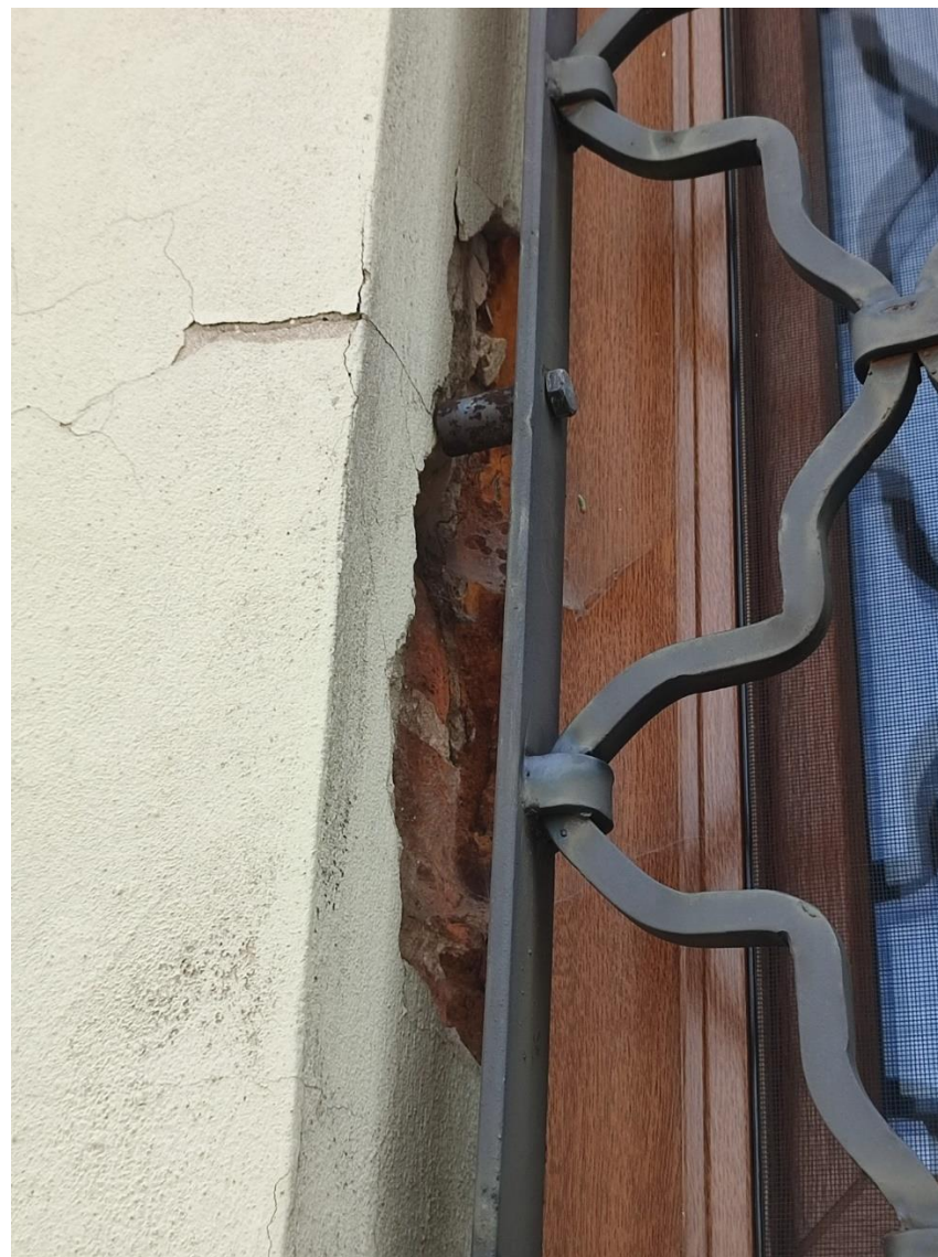
Fot.15 Przykład uszkodzenia glifów okiennych
