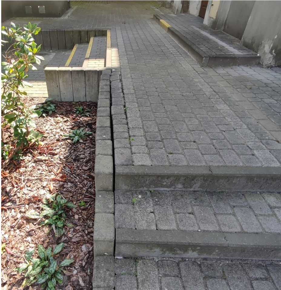
Fot.19 Odspojenia ułożonej kostki oraz osunięcia zgodne z kierunkiem spadku skarpy
